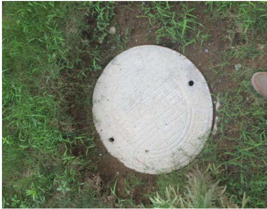
生活污水总排口
