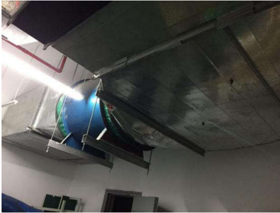
地下车库排风系统
